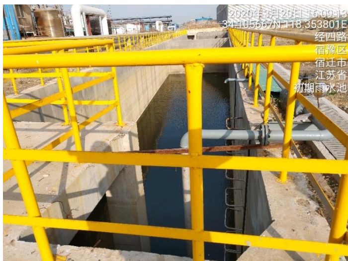
图 4.2-3 初期雨水收集池
