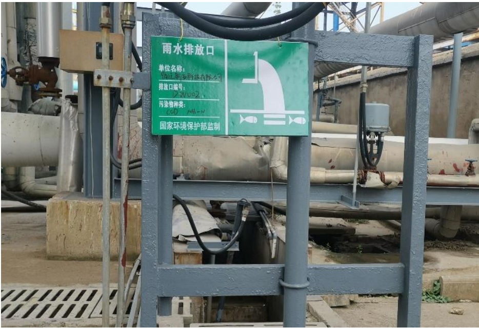
图 10-4 雨水排放口标志牌
