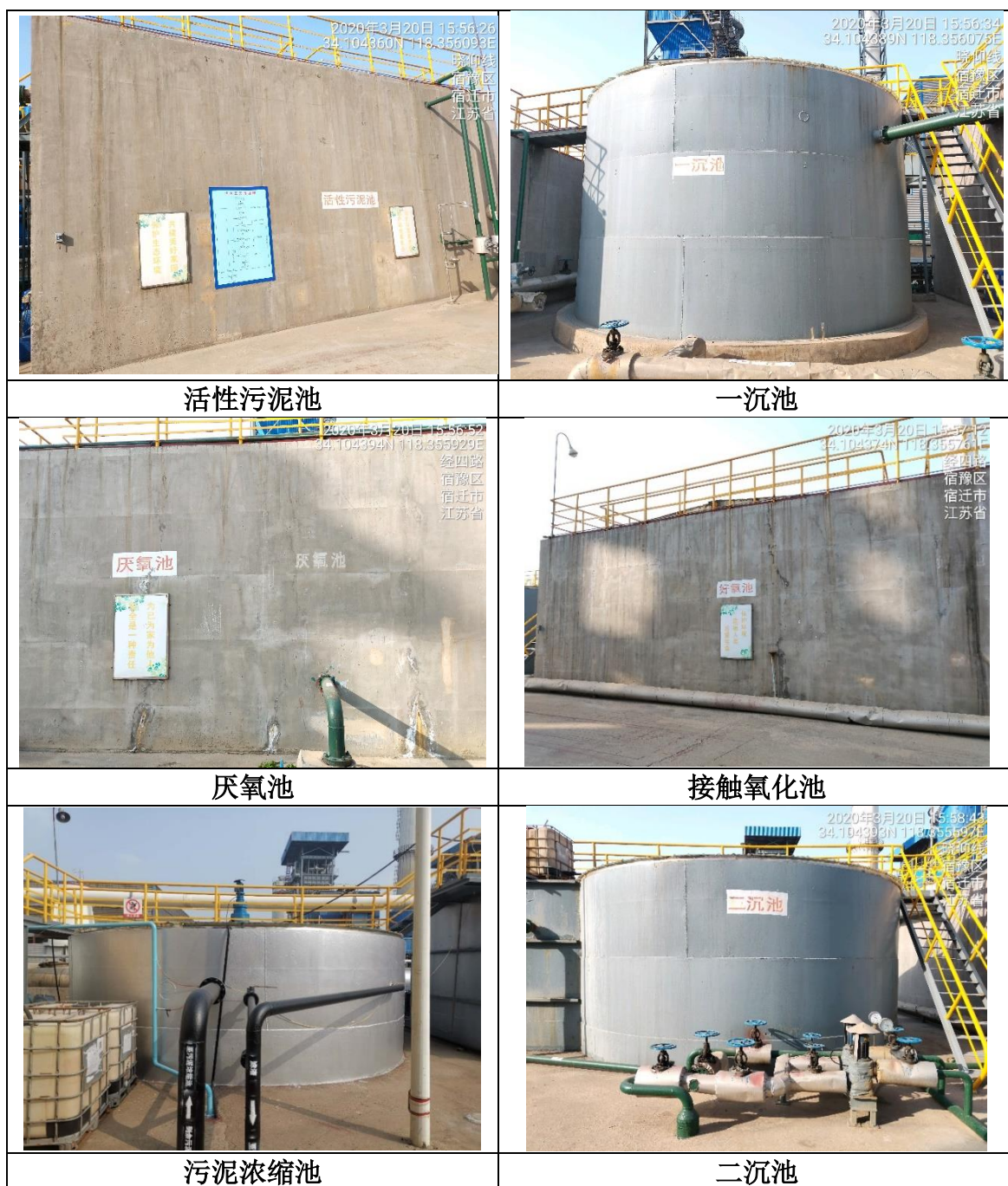
图4.1-3 废水治理设施图片
