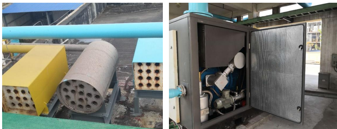
图4.1-5 噪声治理设施图片
